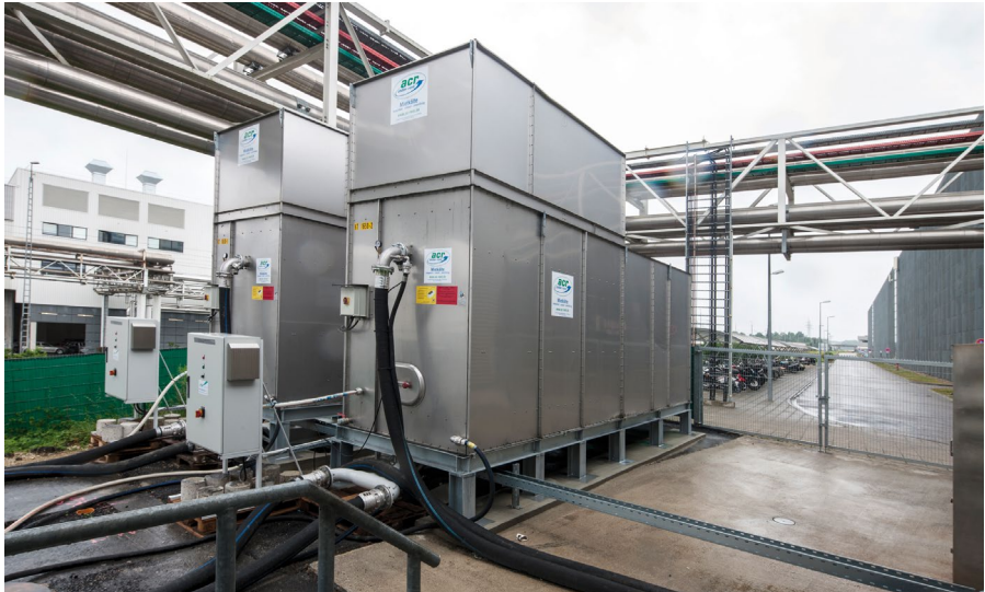
Bild III-21: Installierte Mietkühltürme (Quelle: acr chiller rent GmbH)
